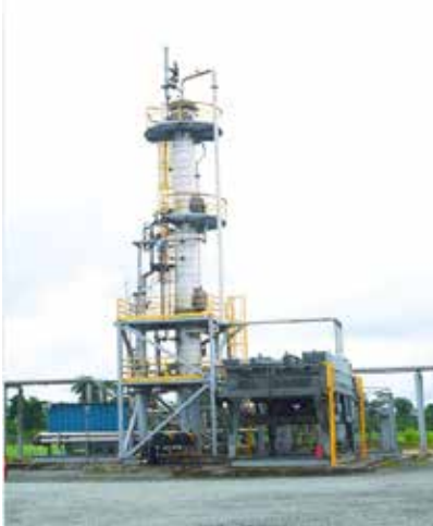
Mini Refinery at Ogbele
